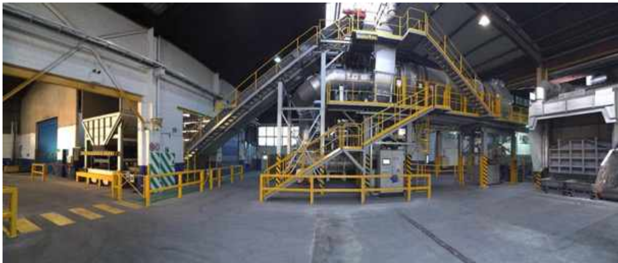
Vue panoramique de la ligne de délaquage et fusion de l'usine Hydro de Clervaux.
